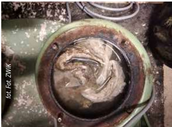
FOT. 1 Zatkana pompa
